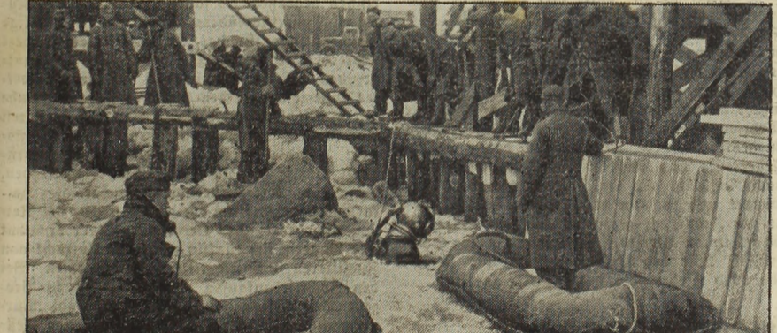
Taucher während des Wintereinsatzes im Osten. Solange das Wetter es gestattet, gehen unsere Pioniere, die im Ostensatz stehen, ihrer Arbeit nach. — Hier geht ein Taucher in dem schon von dicken Eisschollen bedeckten Wasser in die Tiefe. Von den Schlauchbooten wird telephonische Verbindung mit ihm aufrechterhalten. (P.R.-Aufnahme: Kriegsberichtler Göhe, 55., 3.)
