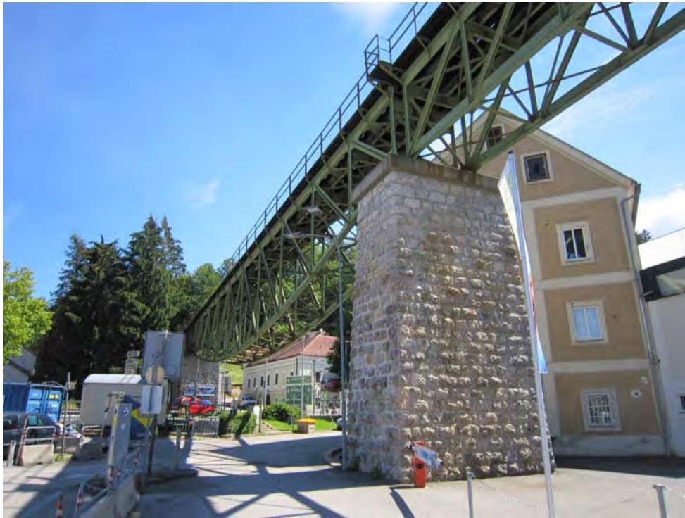
Der mittlere Pfeiler des Ybbstalbahnviadukts, an dem in den letzten Kriegstagen noch eine 500kg Minenbombe angebracht wurde
