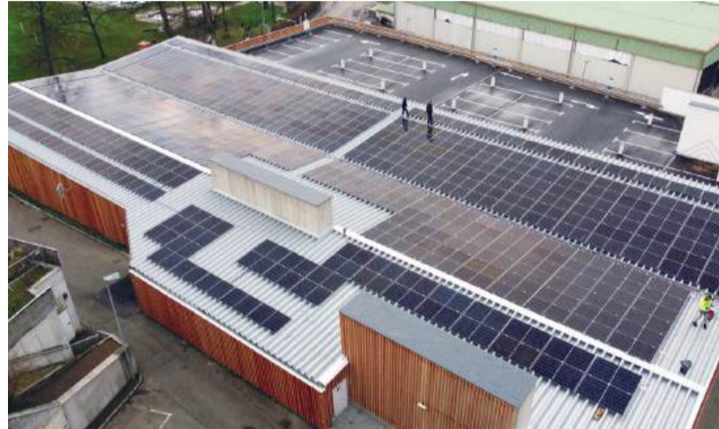
Die neue PV-Anlage am Dach des Parkdecks Schlosscenter ist Teil der umfassenden Photovoltaik-Strategie der Stadt Waidhofen.
