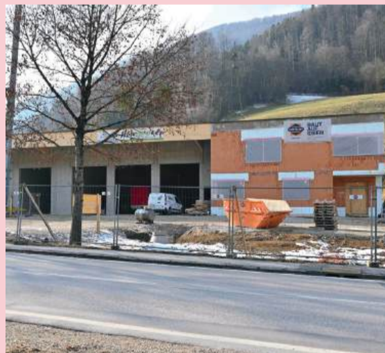
Rohbau – Die ersten Wände stehen, die Dimensionen des neuen Feuerwehrhauses werden sichtbar.
