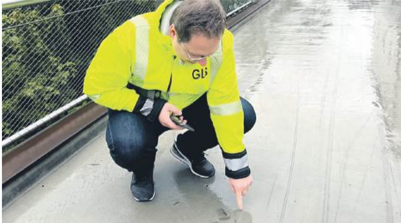
Ein Mitarbeiter der Firma „GLS“ kontrollierte die Kerben im Schlosssteg und beriet sich mit dem städtischen Bauamt über die Vorgehensweise der Sanierung.
