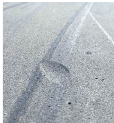
Kerben im Belag schädigen Stege.
