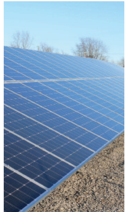
Strom aus regenerativer Sonnenenergie
