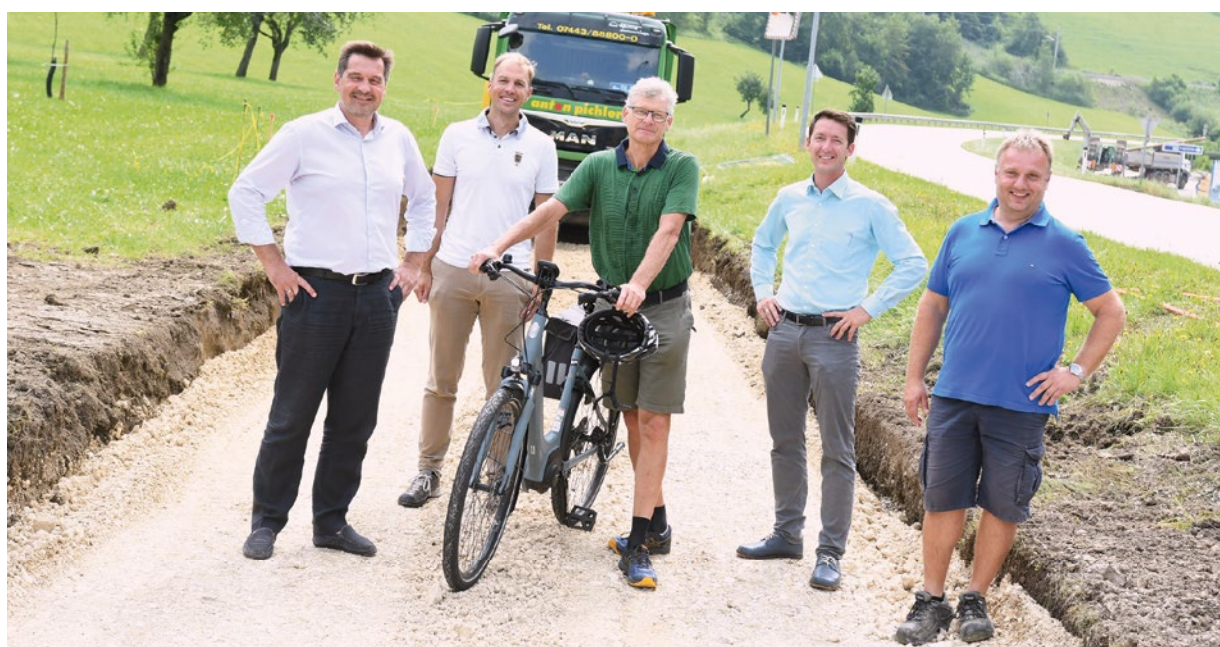
Bürgermeister Werner Krammer, Mario Magnes (Bauamt), Stadtrat Erich Leonhartsberger, Martin Helm (Bauamt) und Leopold Gspörer (Firma Pichler) (v.l.).
