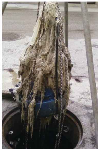
Falsch entsorgte Feuchttücher verstopfen Pumpen und verursachen Schäden.
