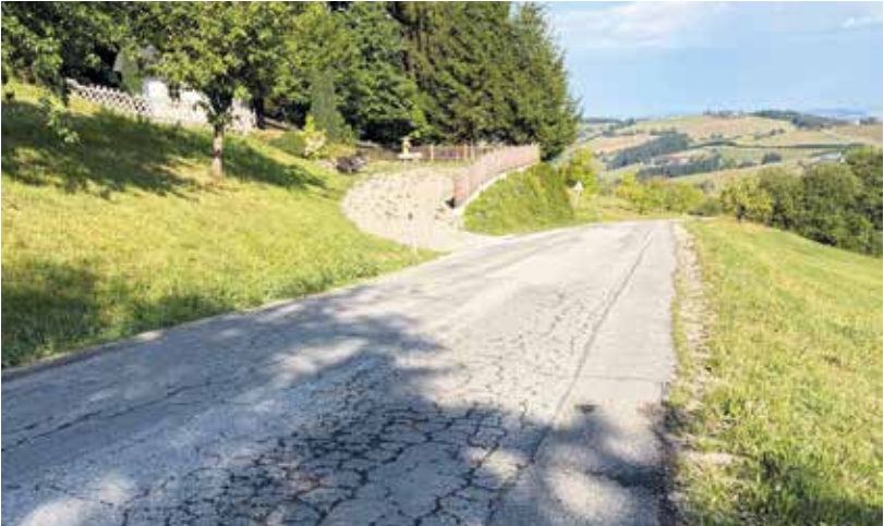
Sanierungsbedarfsichtbar: Schäden an der Fahrbahn zeigen, warum die Mostviertler Höhenstraße auf rund 3,1 Kilometern grundlegend erneuert wird. Die wichtige Verbindung soll damit langfristig sicher und gut befahrbar bleiben.
