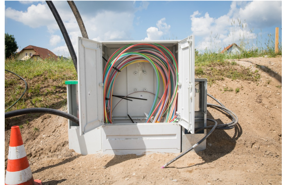
Verteilschränke (FCP, Fiber Concentration Point)
