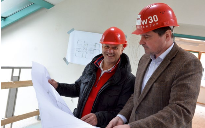
Bauherr Johannes Kühhas und Bürgermeister Werner Krammer beim Baustellenrundgang in der ehemaligen Forstfachschule. Die Pläne versprechen freundliche Wohnungen.
